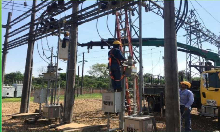
Ilustración 5 Montaje de Reconectores marca ENTEC.
