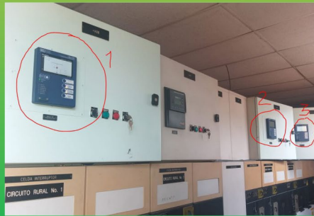
Relés instalados y operando en las celdas de 34.5kV Retorno
