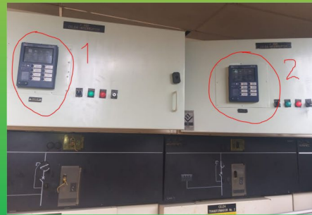
Relés instalados y operando en las celdas de 13.8kV de Retorno.
