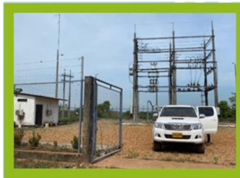
Ilustración 1. Subestaciones operadas por "ENERGUAVIARE S.A. E.S.P. S.A. E.S.P"
