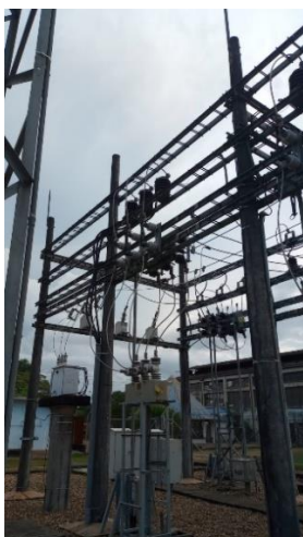
Ilustración 8. CT's N2 – Asociados al módulo de barraje del transformador T01
