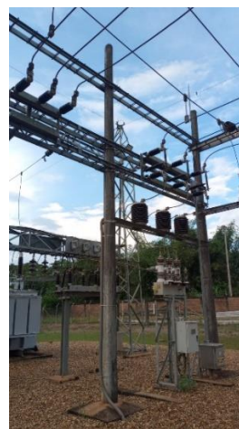
Ilustración 9. CT's N3 – Asociados al módulo de barraje del transformador T02
